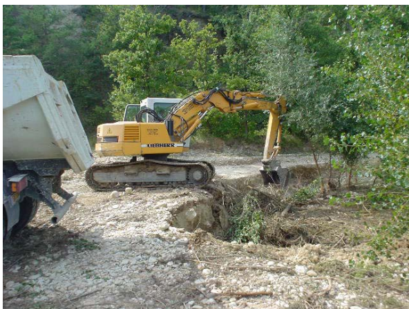
Erosion de berge (Source : SMBVL)
